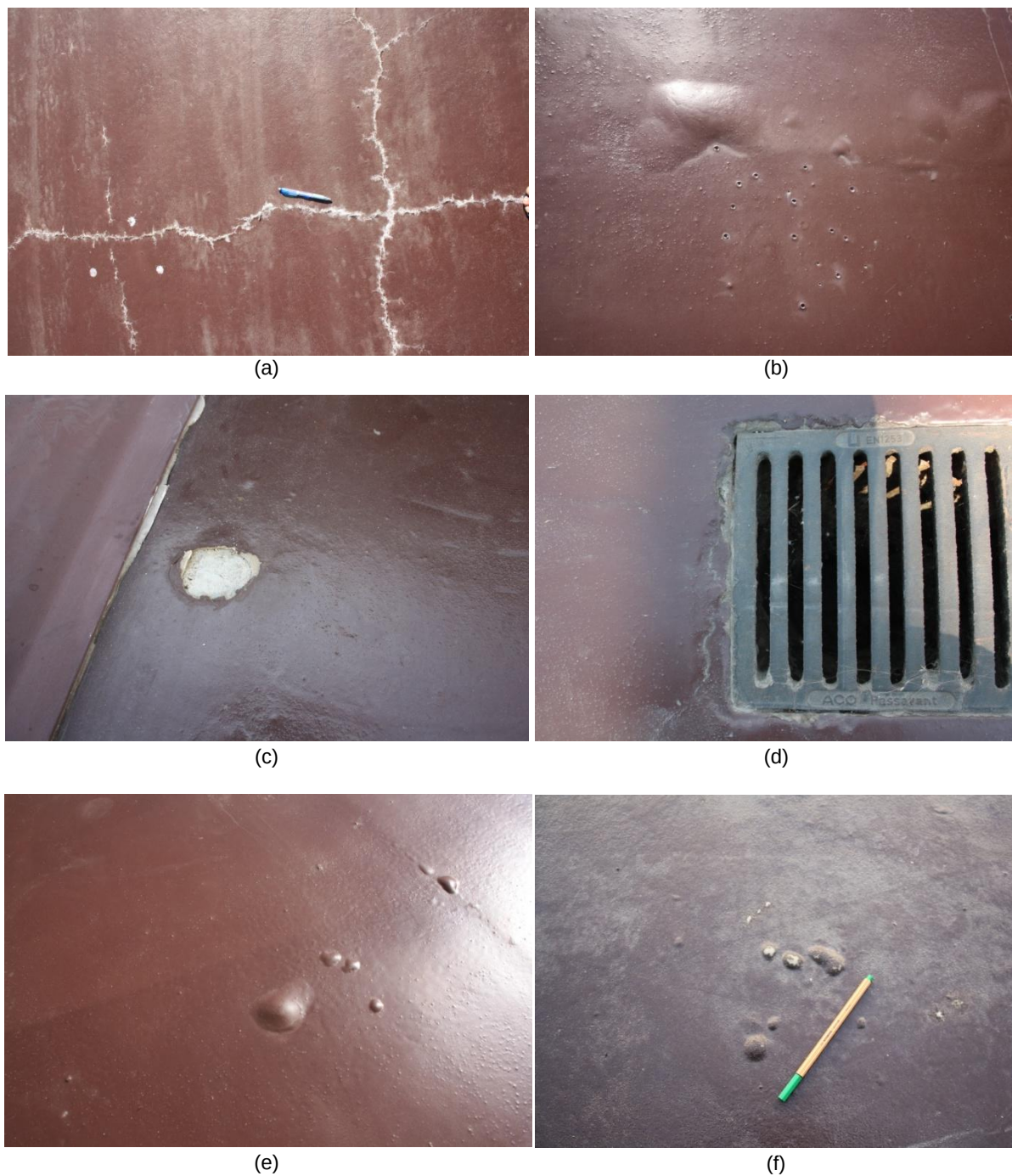
Fig. 59 – Anomalias verificadas no revestimento à base de resinas de metacrilatos.
