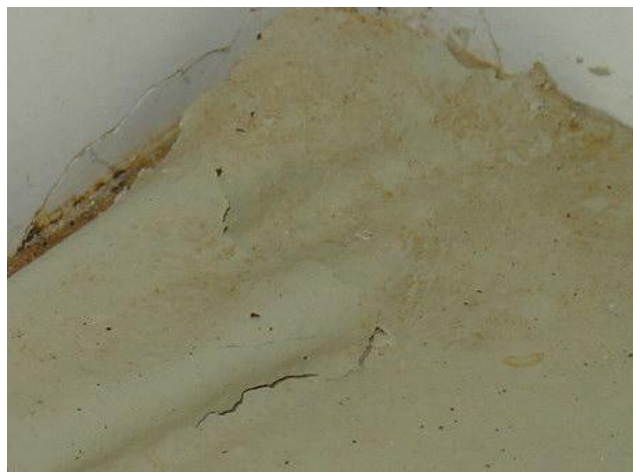
Fig. 22 – Exemplo de empolamento de um revestimento (Garcia, J., 2006).
