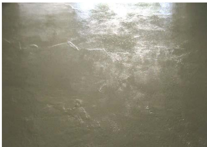
Fig. 26 – Revestimento com falta de planimetria (Garcia, J., 2006).
