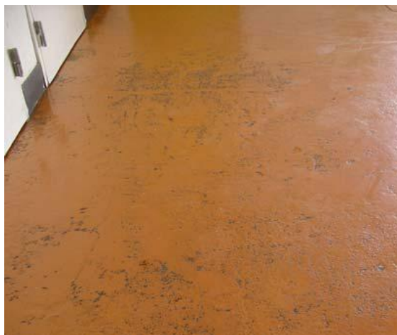
Fig. 25 – Sinais de desgaste de um revestimento à base de resinas sintéticas (Garcia, J., 2006).
