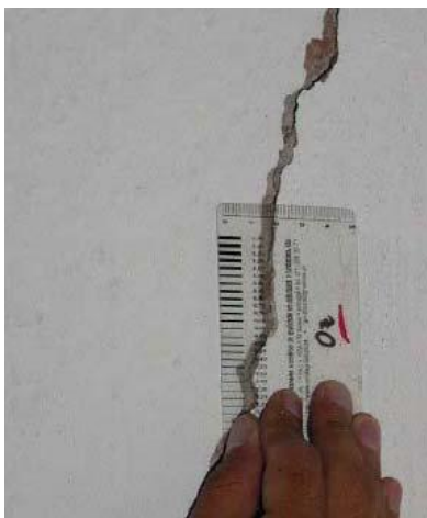
Fig. 33 – Medição de fissuras com um comparador (Garcia, J., 2006).
