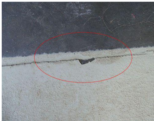
Fig. 42 – Falta de aderência entre a base e o revestimento (Garcia, J., 2006).
