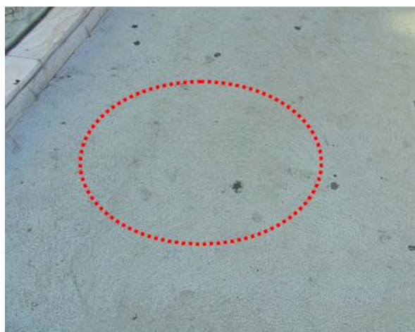
Fig. 29 – Revestimento à base de resinas sintéticas com perda de tonalidade (Garcia, J., 2006).
