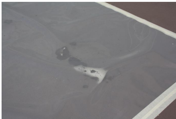
Fig. 68 – Filme de polietileno com presença de condensação.
