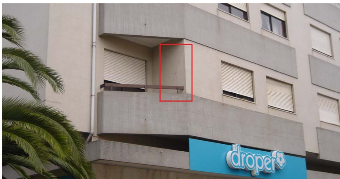
Fig 2.9 – Caso real de fissuração de parede de alvenaria devida à deformação de laje em consola
