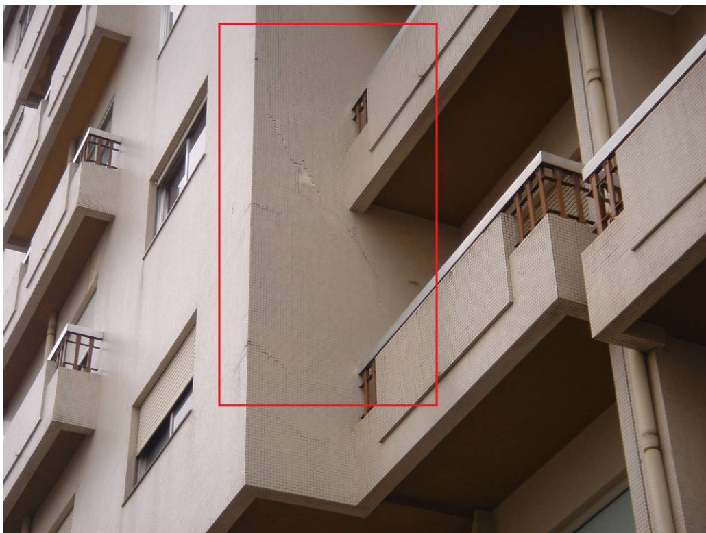
Fig 2.8 – Caso real de fissuração de parede de alvenaria devida à deformação de laje em consola.
