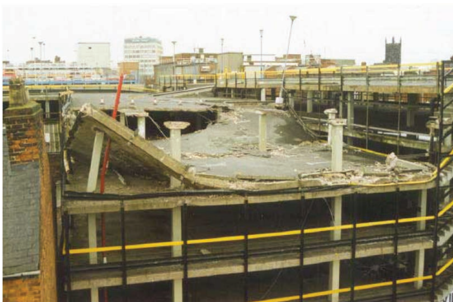
Figura II-2 - Colapso parcial do 4.º piso de um parque de estacionamento em Wolverhampton, Reino Unido (Wood, 2002).
