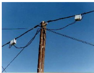
Figura 3.30. – Poste de electricidade, [90].
