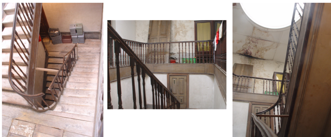
Fig. 22 Estado de degradação do edifício
