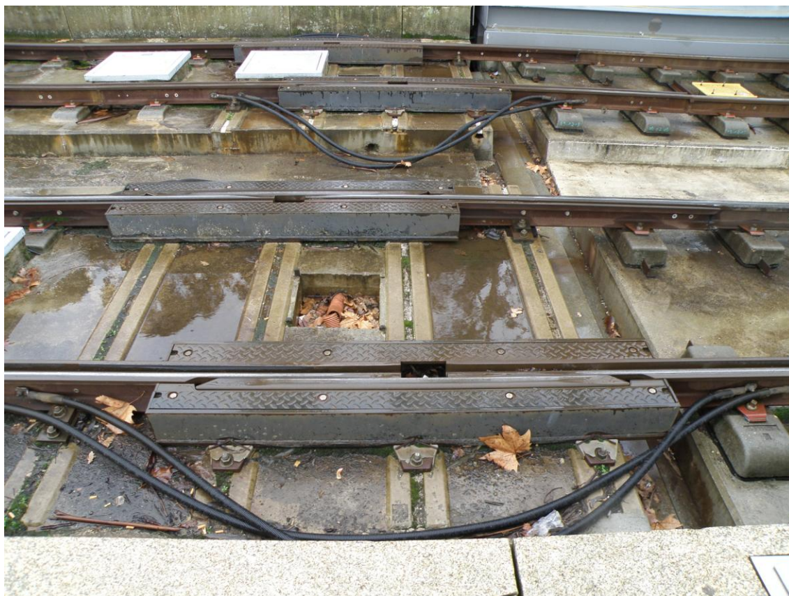
Fig. 25 – Juntas de dilatação
