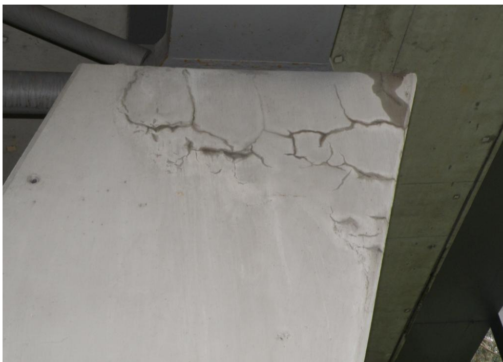
Fig. 27 – Pilar com sinais de deterioração
