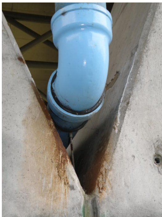
Fig. 26 – Patologia registada junto a uma curva de um tubo
