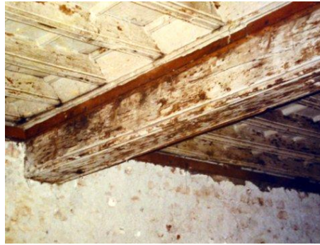
Fig. 2.21 - Avaliação do estado de conservação de pavimento antigo [77]
