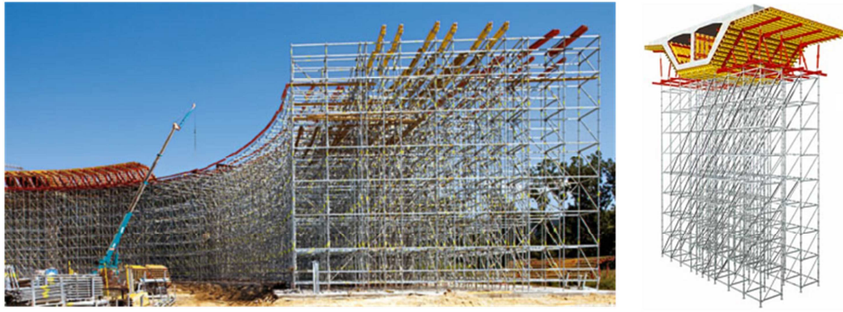
Figura 5 - Sistema de Cimbra ao Solo Constituído Por Colunas de Tubos de Andaime [8] [9]
