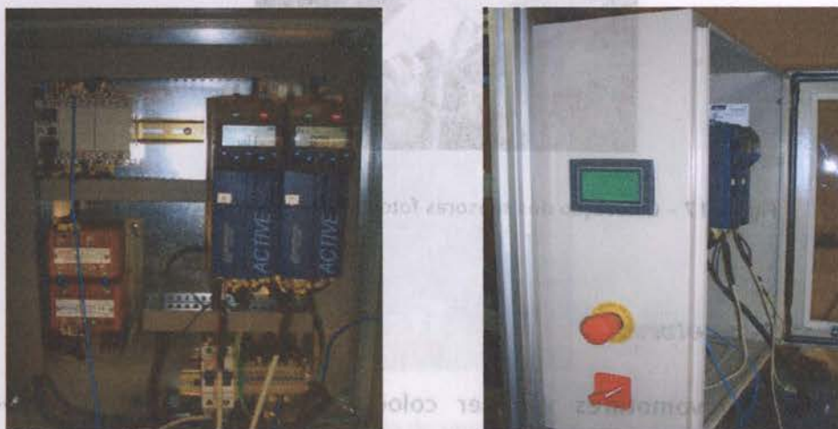
Figura 19 - Vista Frontal e Lateral do Quadro Eléctrico
