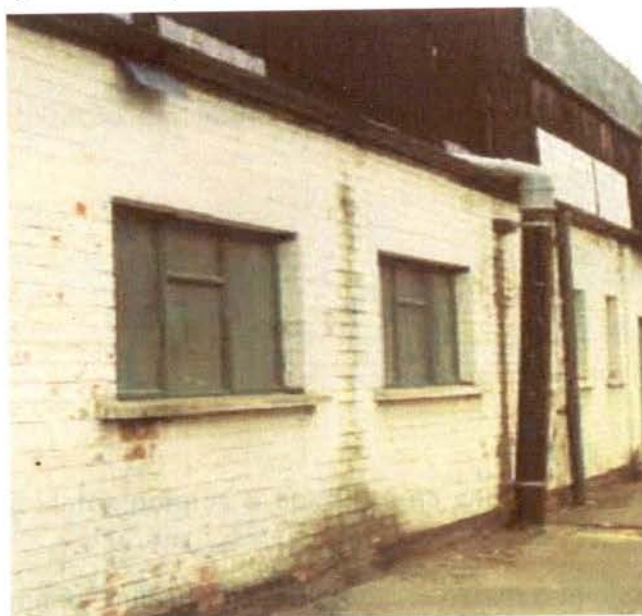
Figura 3 Reboco com fungos.
