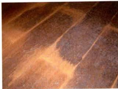
Figura 1 Madeira contaminada com um fungo xilófago que provocou alteração de cor.
