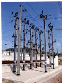
Figura 29 - Posto de Barramento
