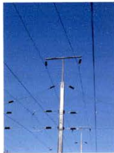
Figura 3 - Feeder montado em postes de catenária
