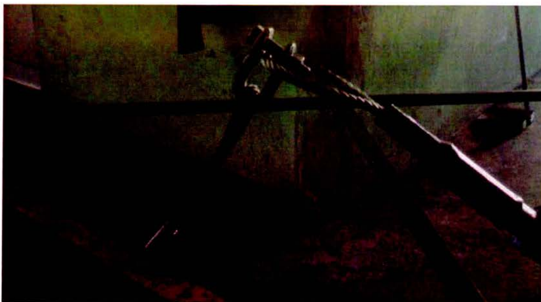
Figura 10: Conexão entre fio e cabo
