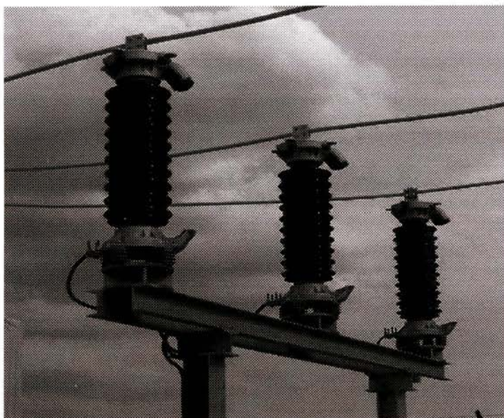
Figura 4. Descarregadores de tensão
