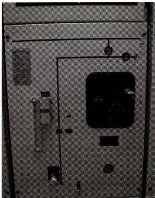
Figura 13. Celas - Painél de manobra do seccionador
