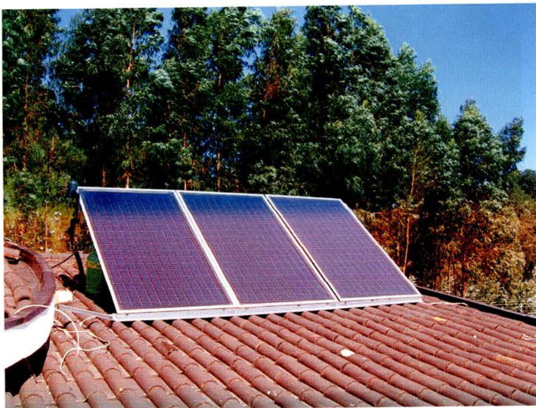
Fig.3. – Instalação de Sistema Solar com 3 colectores em Gondomar
