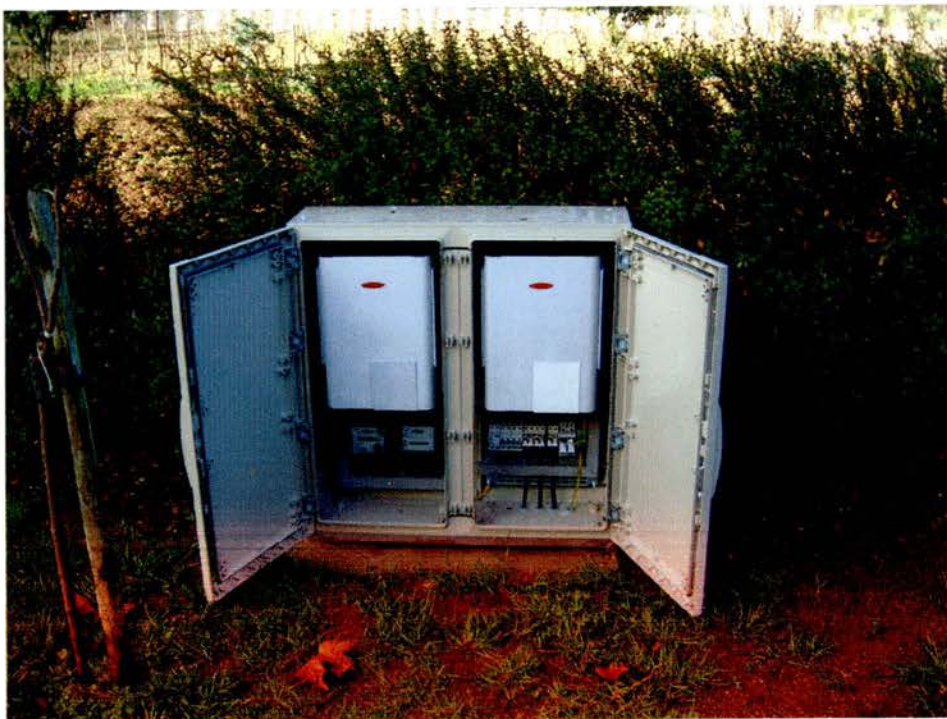
Fig.2 – Caixa dos inversores e contadores da Instalação Fotovoltaica da Mealhada
