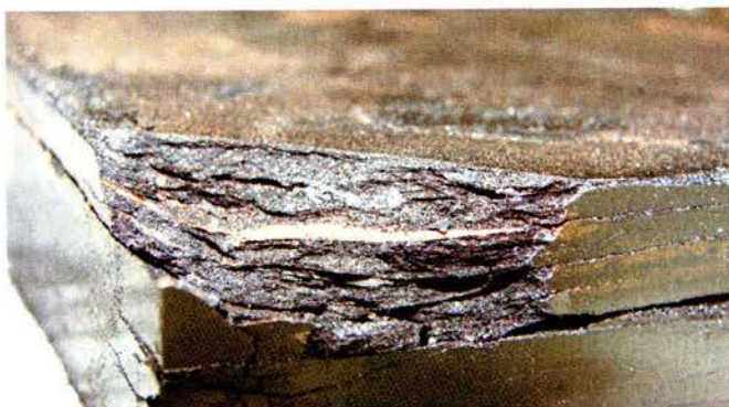
Figura 38 – Pormenor do defeito no canto da placa
