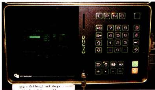
Figura 28 – Comando numérico instalado na prensa hidráulica.
