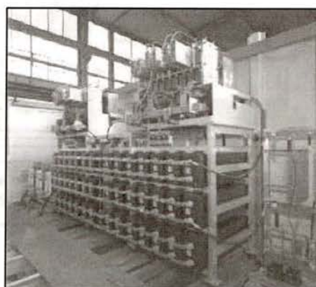
Figura nº 6.3- Exemplo de um DVR baseada em IGCTs, montado em cima de um banco de condensadores,[6]
