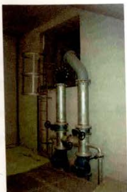
Figura 16 – Sistema de Bombagem
