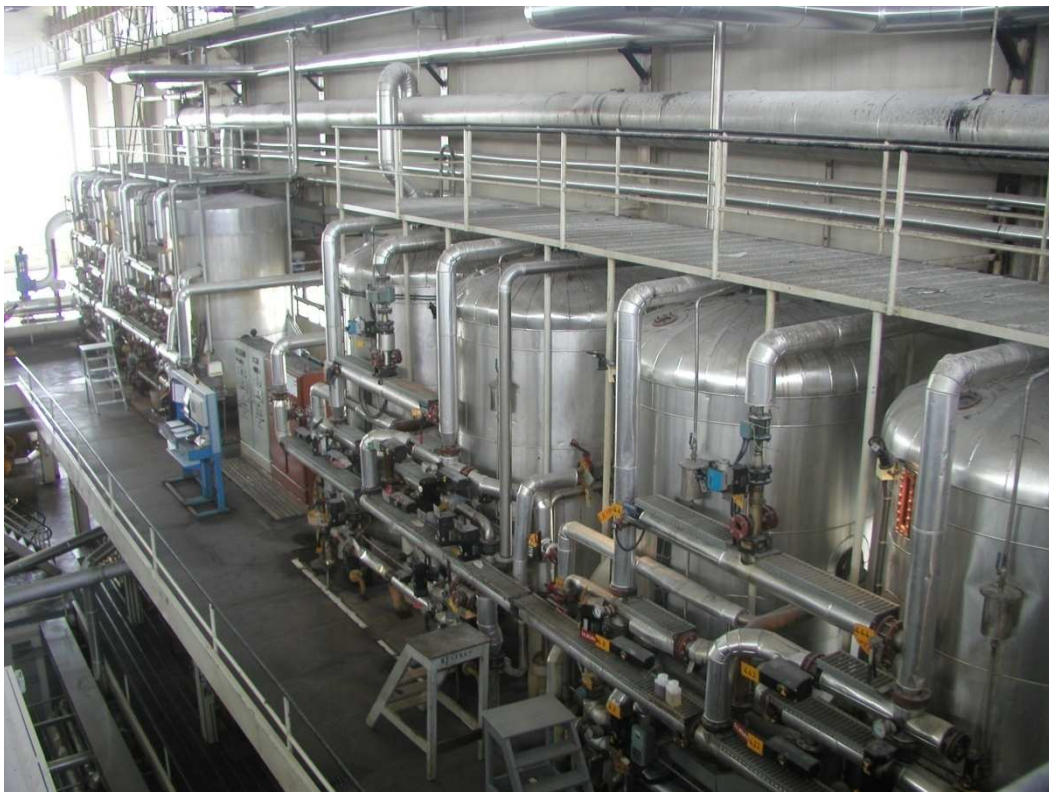
Figura 1 – Sistema de descoloração da refinaria da RAR.
