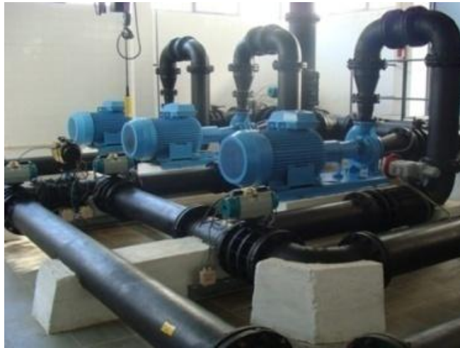
Figura 3. Grupos electrobomba de captação (Águas do Ave, S.A., 2008).
