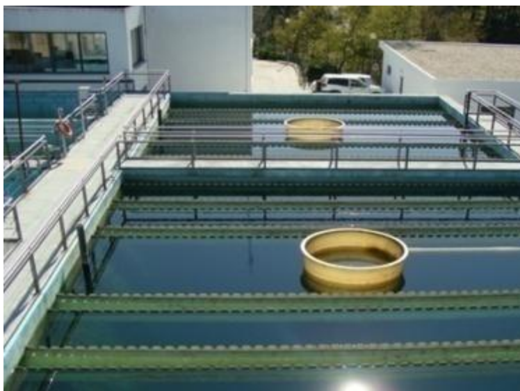
Figura 5. Decantadores de manto de lamas (Águas do Ave, S.A., 2008).
