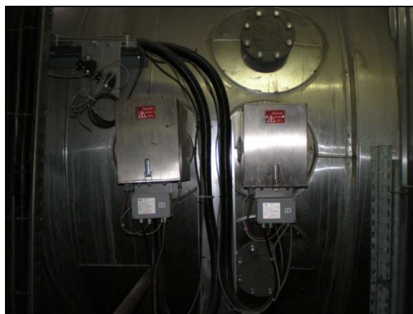
Figura 12 - Amostradores na conduta de extracção de gases.
