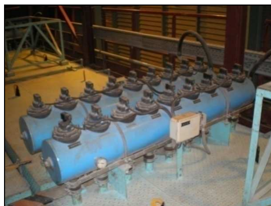
Figura 10 - Injectores de ar comprimido no filtro de mangas.
