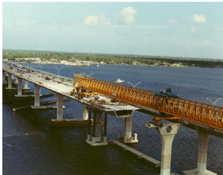
Fig.9 – Viga de lançamento para aduelas pré-fabricadas [11]
