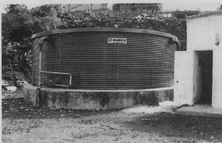
Fig. 18 – Reservatório de abastecimento à ETRS.
