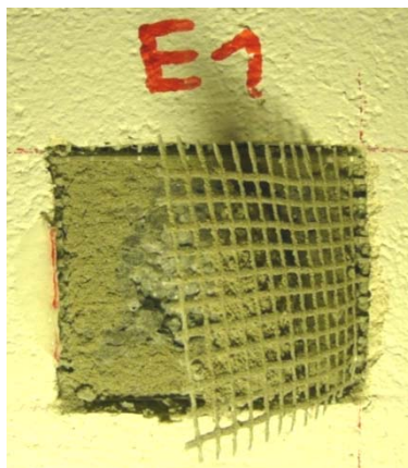
Fig. 58 – Pormenor da armadura de fibra de vidro deficientemente cortada
