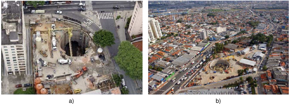
Figura 2.3 – Poços circulares no Metro de S. Paulo (Topa Gomes, 2008): a) Poço Jardins – Acesso estação Óscar Freire – linha 4 Metro S. Paulo; b) Poço Sul – estação Vila Prudente – Metro S. Paulo
