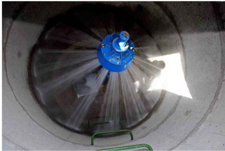
Fig.4.15. – Segunda Imagem de uma Válvula de Alívio Instalada numa Conduta Quando em Funcionamento
