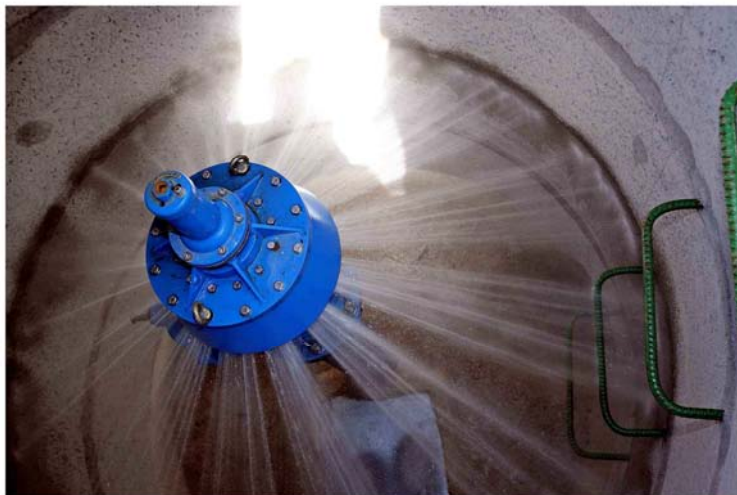
Fig.4.14. – Primeira Imagem de uma Válvula de Alívio Instalada numa Conduto Quando em Funcionamento
