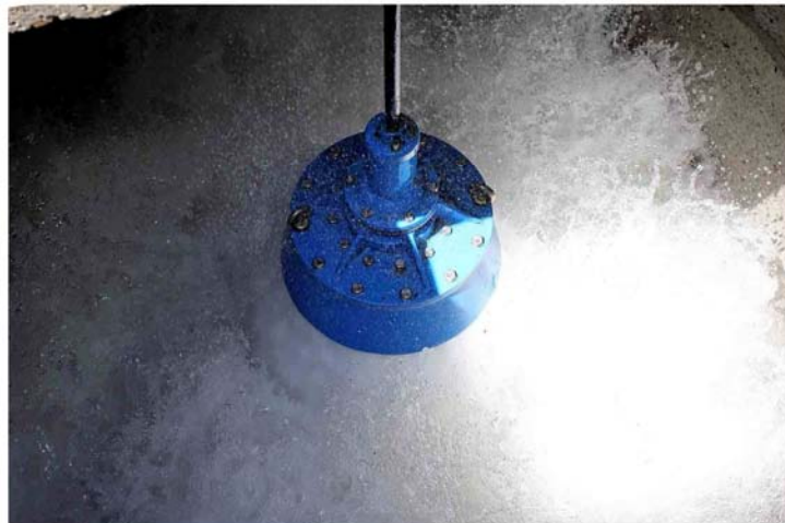
Fig.4.16. – Terceira Imagem de uma Válvula de Alívio Instalada numa Conduta Quando em Funcionamento
