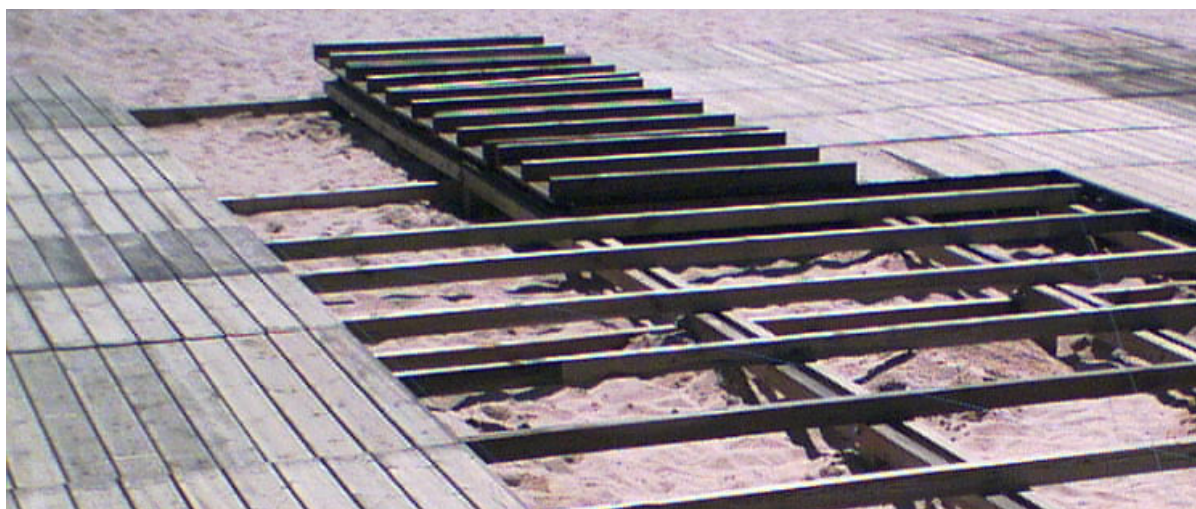
Fig. 39 – Estado de madeira construído com irregularidade
