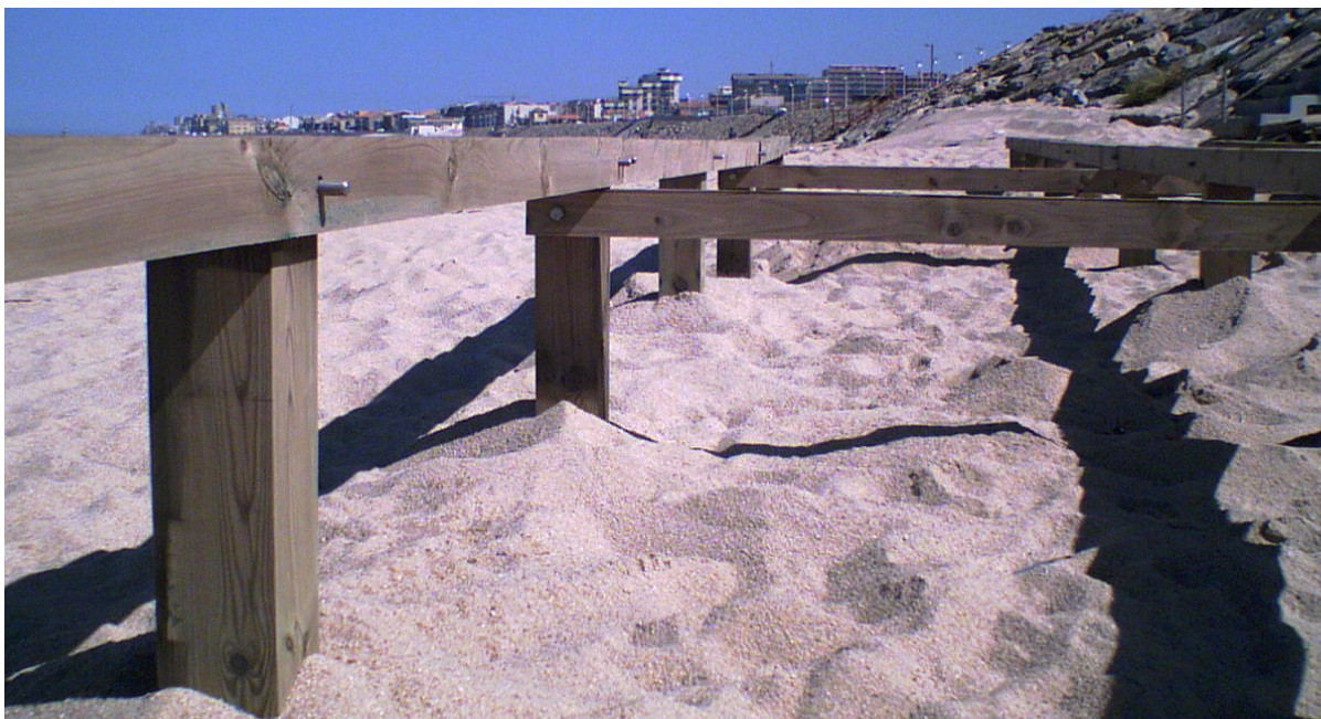
Fig. 38 – Irregularidade no estrado de madeira
