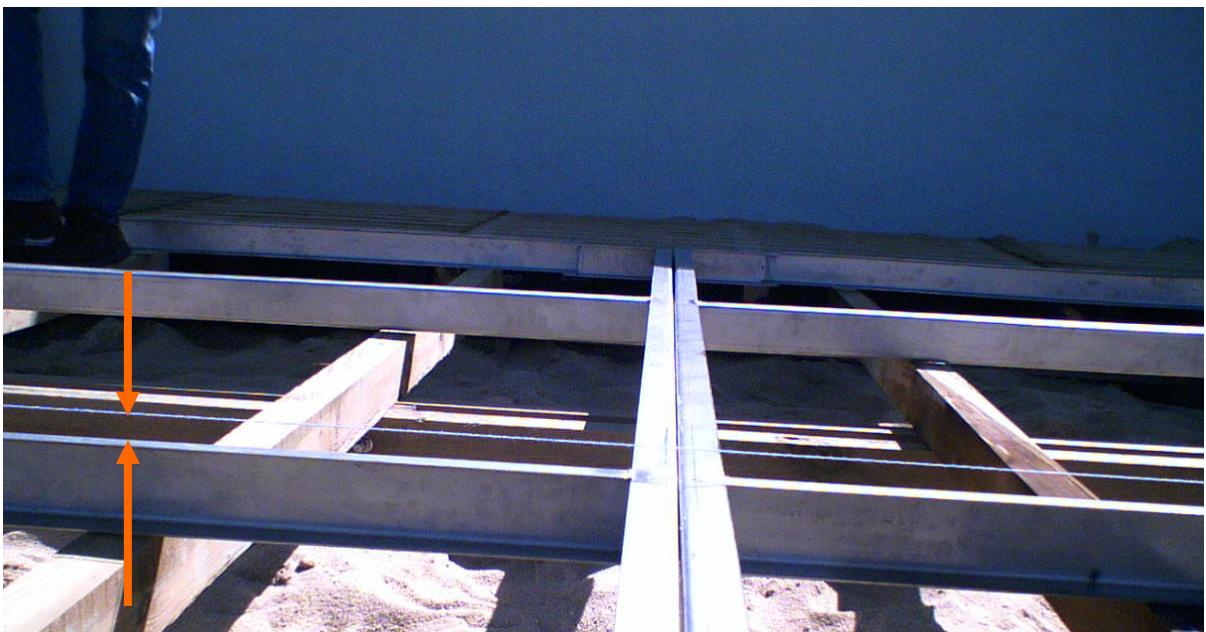
Fig. 41 - Desvio no estrado de aço inox provocado pela irregularidade da estrutura de recepção
