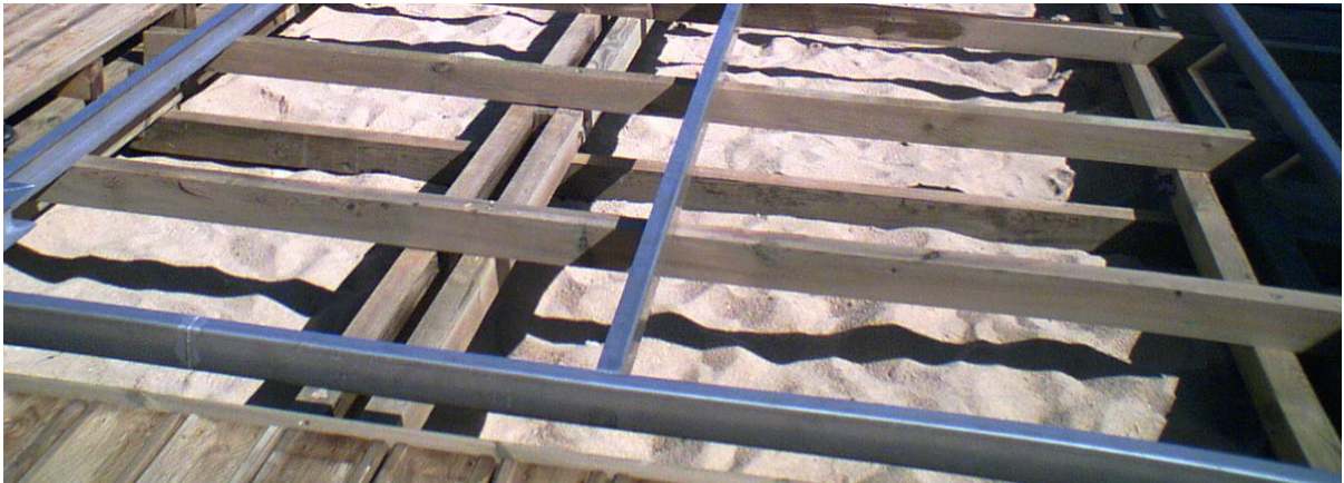
Fig. 40 - Estrado de aço inox colocado sobre o estrado de recepção de madeira
