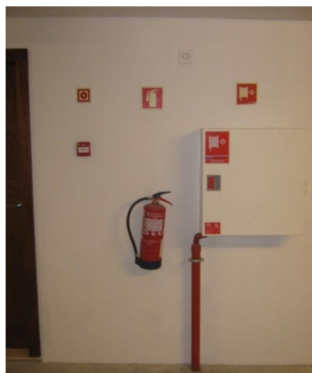
Fig.2.41 – Sinalização de meios de combate a incêndio
