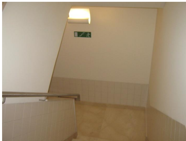
Fig.2.40 – Iluminação e sinalização da saída dentro da caixa de escadas entre 2 pisos de habitação
