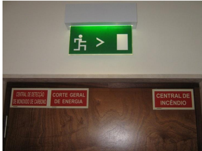
Fig.2.39 – Indicação de saída e de central de comando
