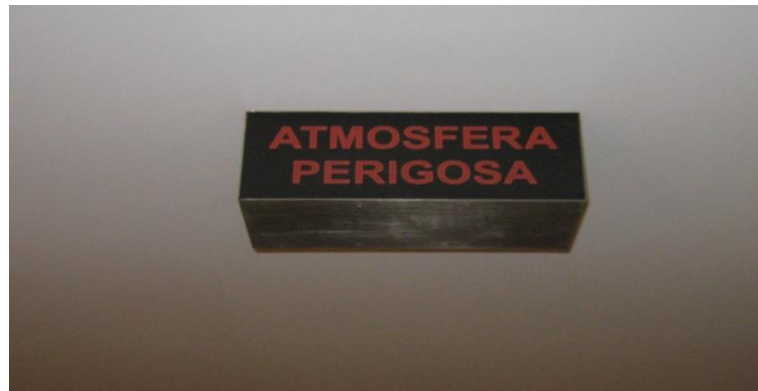
Fig.2.35 – Sinal referente à detecção de gás combustível
