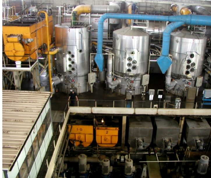
Figura 2 - Sector da Recuperação da Refinaria
