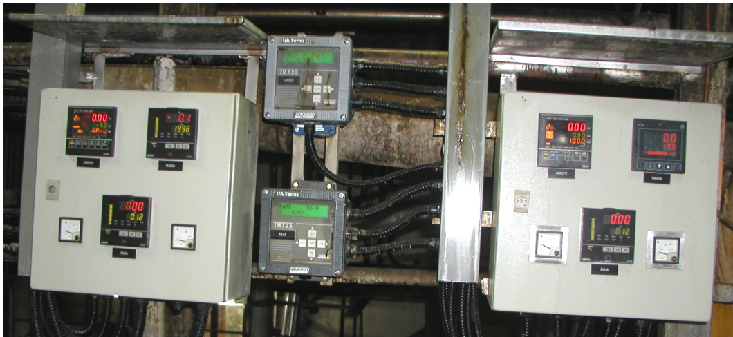
Figura 9 - Sistema de controlo da centrifugação.
