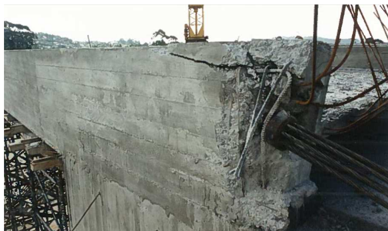
Fig.1.1. – Representação de rotura junto de uma zona de ancoragem
