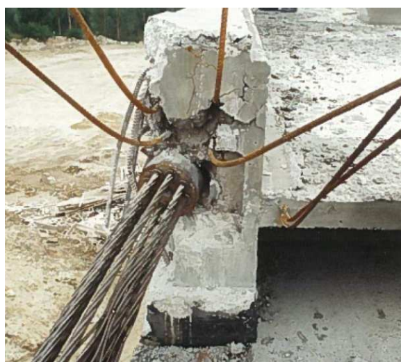
Fig.1.2. – Representação de rotura junto de uma zona de ancoragem
