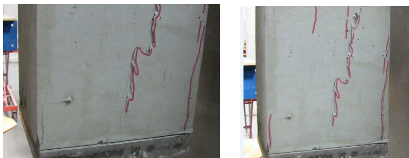
Fig.4.14 – Fendilhação na base
