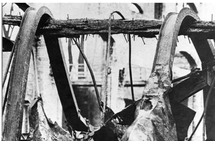
Fig.4.6 – Vigas de madeira e aço após um incêndio [14]
