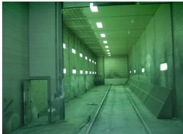
Figura 36 – Perspectiva de uma das câmaras de pintura
