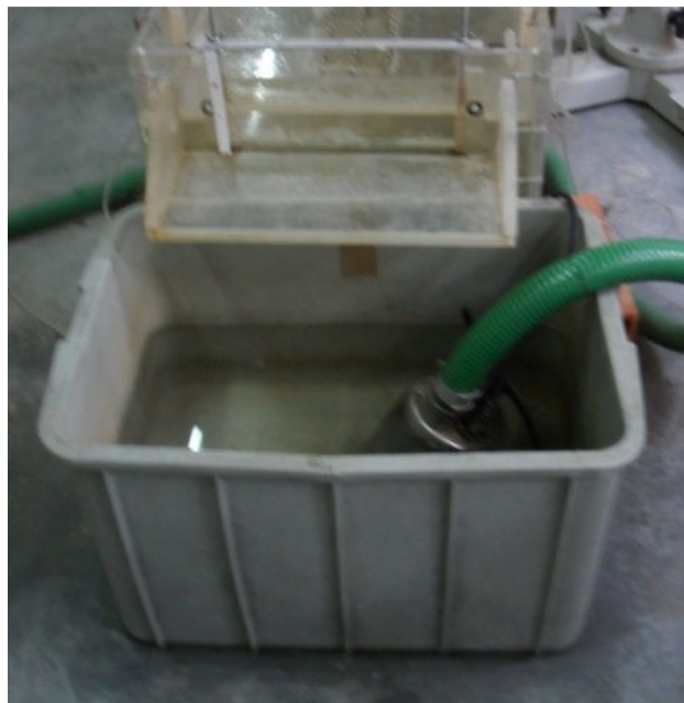
Figura 3.6. - Reservatório de Bombagem com bomba submersível
