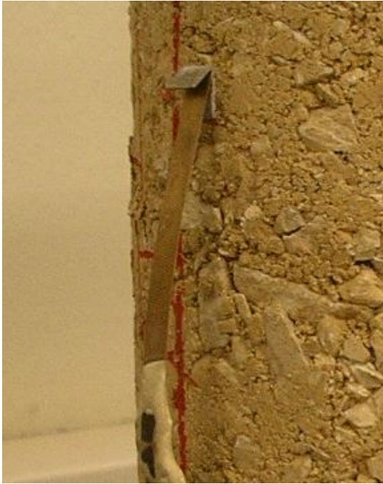
Figura 3.52 – Pormenor do sistema de ancoragem
