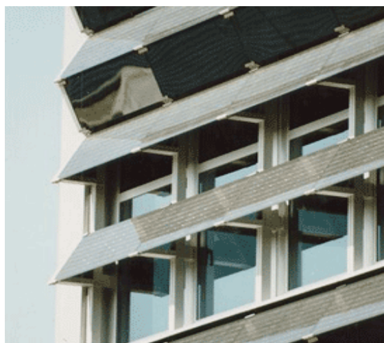
Figura 2.43 - Dispositivo solar de sombreamento: palas de sombreamento nas janelas [42].
