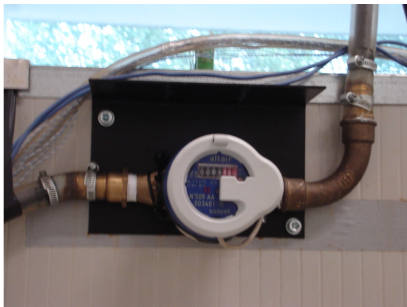
Figura 9 – Contador de água.
