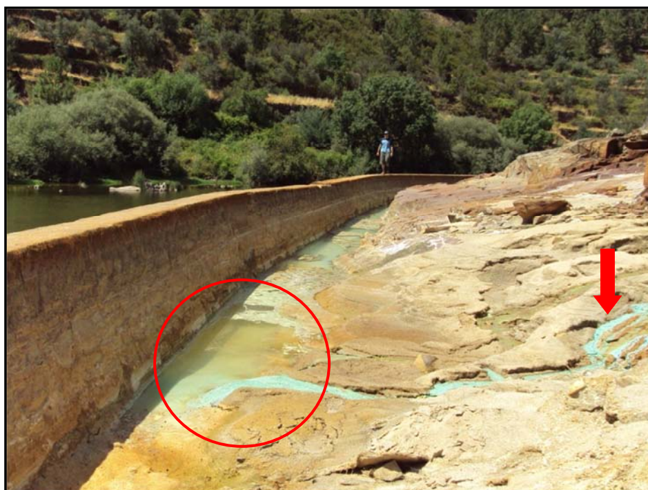
Fig. 63. Vista do terraço inferior a parte norte da base da Escombreira, em que está destacado a vermelho as drenagens ácidas e a sua acumulação.
