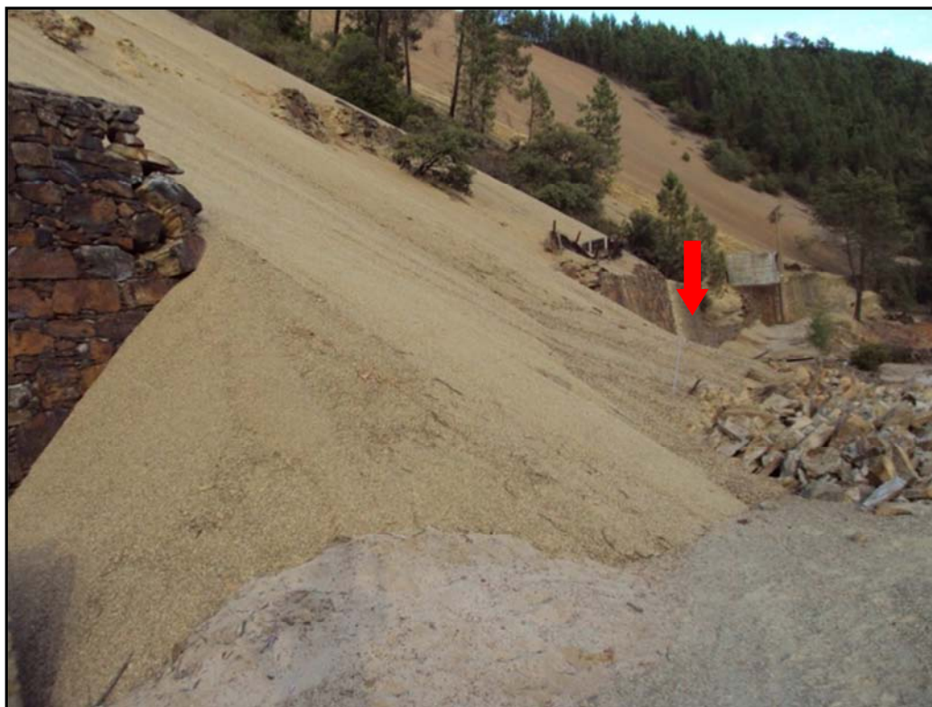
Fig. 43. Tramo final da conduta superficial antes de entrar na Estação de Bombagem ao fundo, em que é visível uma derrocada recente de escombros a obstruir a conduta e a vermelho os locais de recolha de A7 e BE1*.
