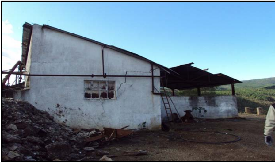
Fig. 32. Estação de Tratamento de Águas (ETA).
