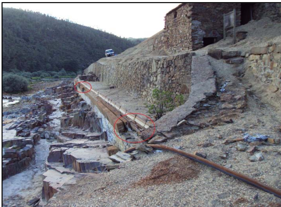
Fig. 60. Vista da conduta, antes do local de recolha de A5 e A6 na base da Escombreira com destaque a vermelho para os locais mais degradados.
