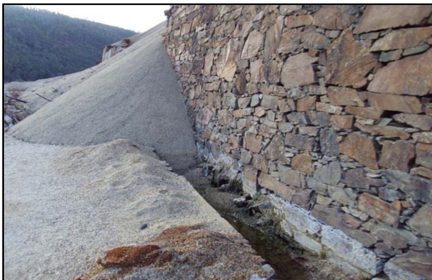
Fig. 58. Local de recolha da amostra de B1*, em que é visível uma derrocada recente de Escombro a tapar a conduta das águas.
