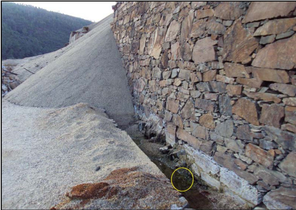
Fig. 44. Tramo final da conduta superficial antes de entrar na Estação de Bombagem recoberto por escombros de uma derrocada mais recente, em que é visível a amarelo o local onde se recolheu a amostra de água A7.
