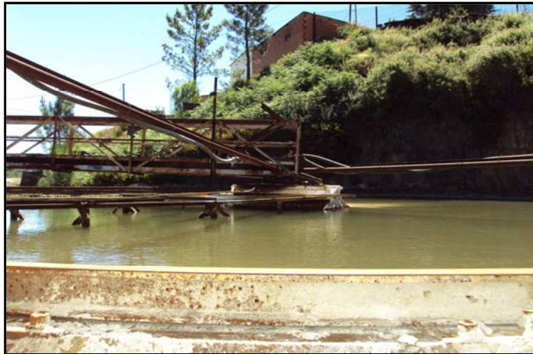
Fig. 33. Local de recolha e tratamento das águas.
