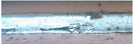
Figura 3.2.8 – Inclusão de escória no cordão
