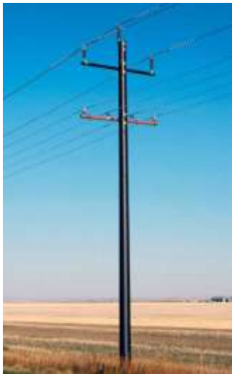
Ilustração 45 Poste em compósito
