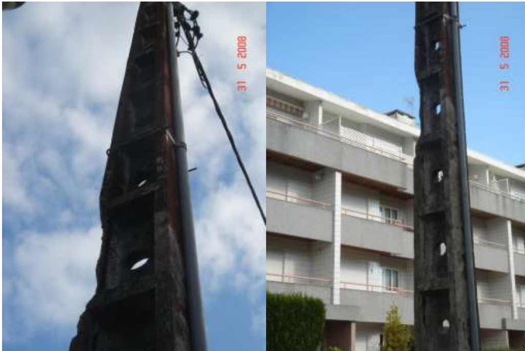
Ilustração 37 Poste em degradação. Betão armado
