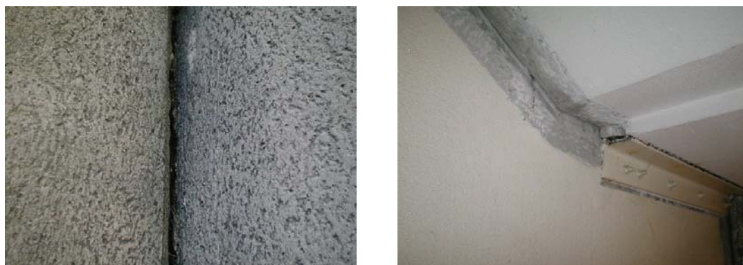
Figura 3.24 - Caixa de escadas - Juntas de dilatação/Deterioração das juntas de dilatação, AI-1.
