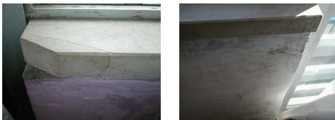
Figura 3.23 - Janelas – Peitoris/Deterioração dos peitoris, AE-10.
