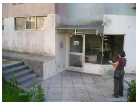
Figura 4.18 - Coberto colocado numa entrada de tipologia de “ângulo” (anterior).
