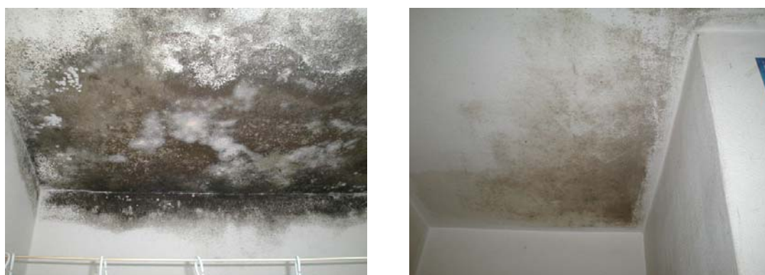
Figura 3.25 - Tectos / Paredes/Infiltrações e condensações, AI-2.
