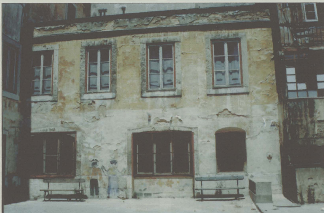
Estado avançado de degradação do Edifício – Imagens diversas
