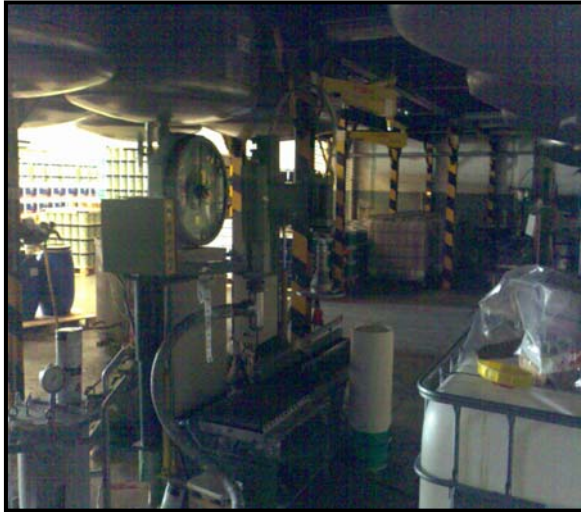
Figura 9 – Centro de Trabalho de Enchimento Semi-Automático
