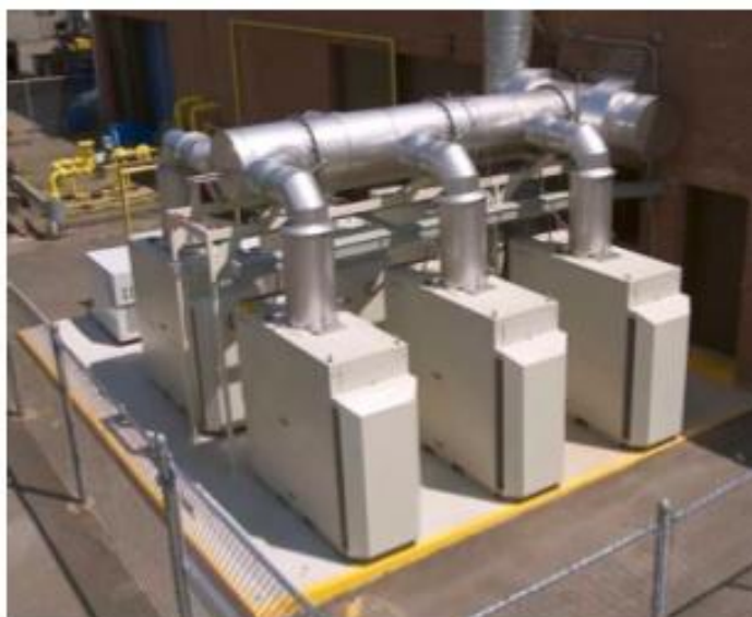
Figura 2.9 - Instalação de cogeração com Micro-turbinas[10]
