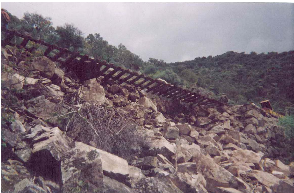
Figura 7.13 – Estragos na via causados pelo escorregamento de grandes massas de Abril de 2000 – visto de baixo (fonte: REFER)
