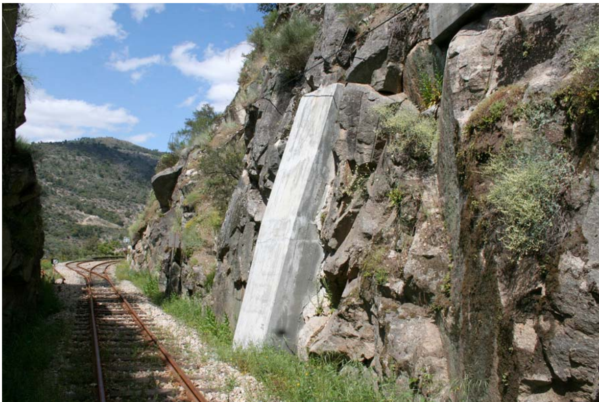
Figura 7.5 – Calçamento de bloco rochoso (fotografia do autor)
