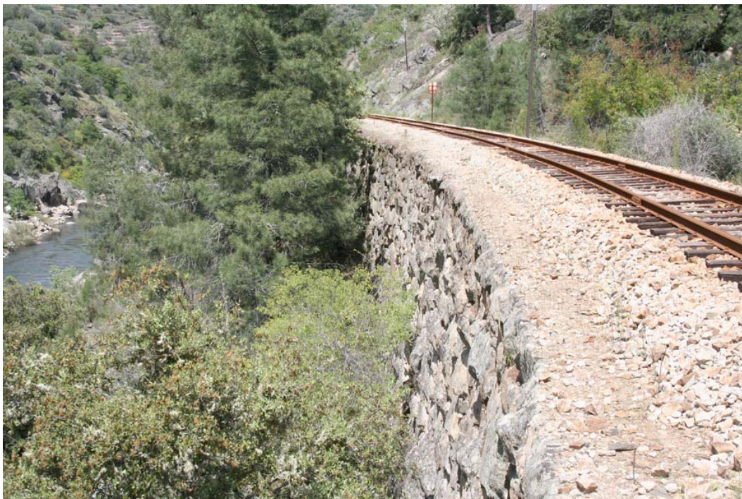
Figura 4.34 – Muro de suporte, Pk 15,000-16,000 (fotografia do autor)
