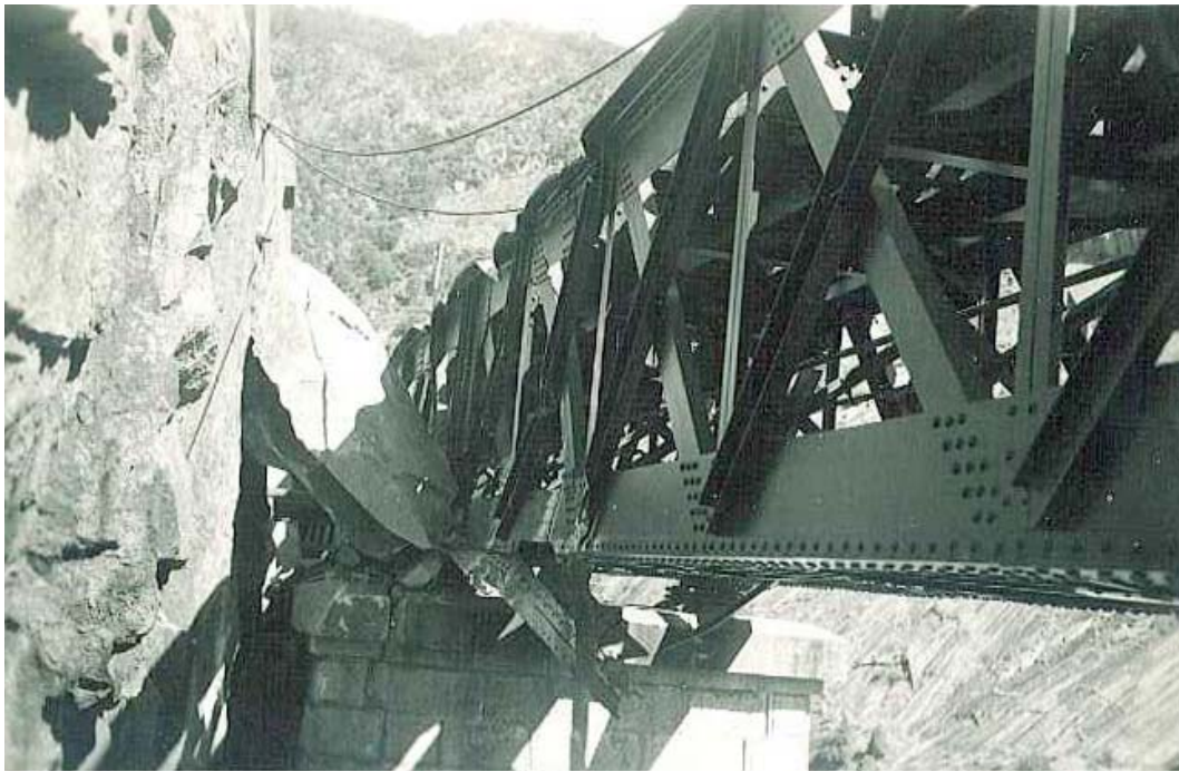
Figura 6.3 – Estragos no viaduto das Fragas Más causados pela queda de um bloco rochoso (fonte: REFER)
