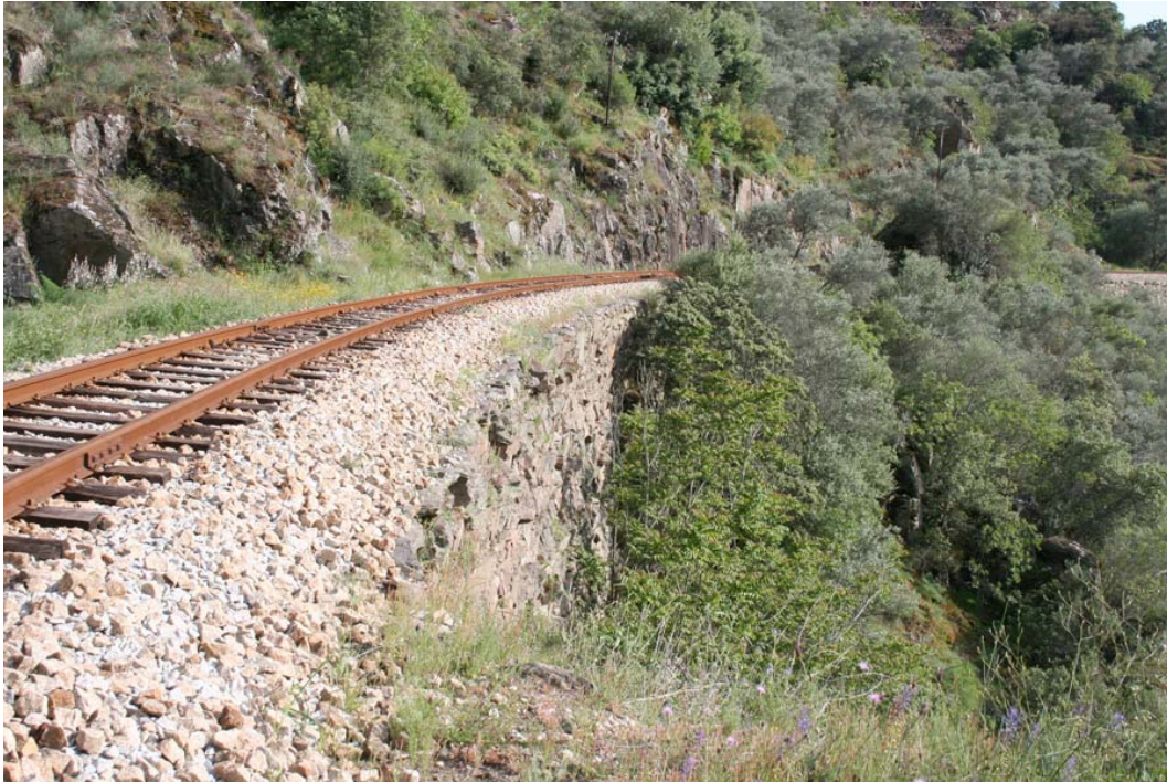
Figura 4.32 – Muro de Suporte, Pk 4,000-5,000 (fotografia do autor)
