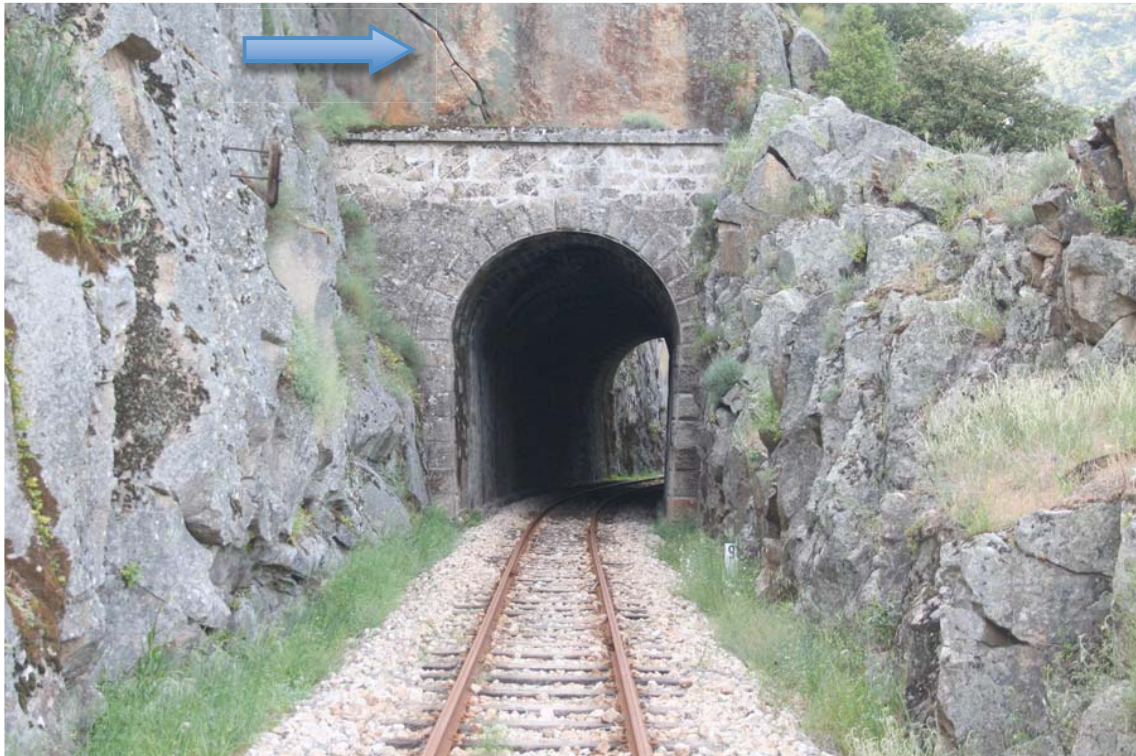
Figura 5.11 – Fractura do maciço (fotografia do autor)
