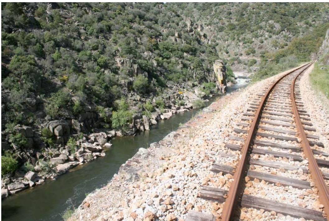
Figura 4.33 – Muro de Suporte, Pk 9,000-10,000 (fotografia do autor)
