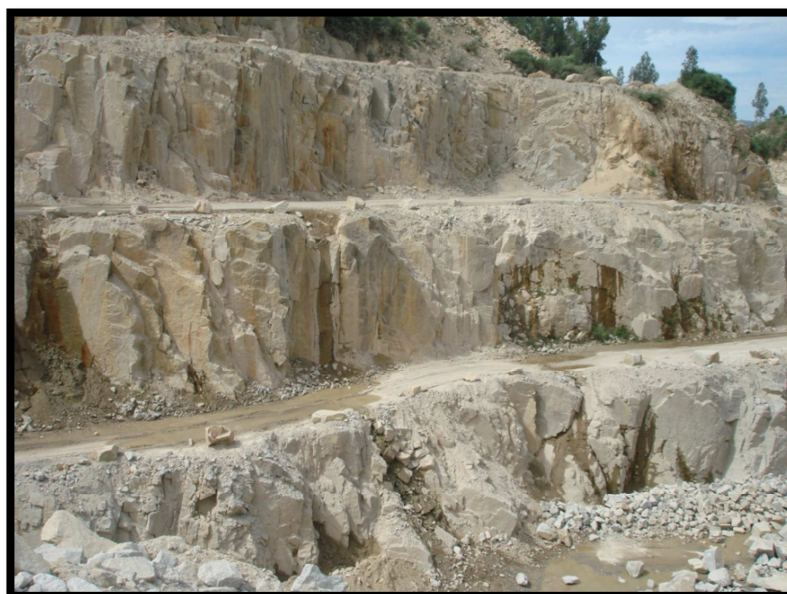
Ilustração 20: Bancadas já desmontadas que ilustram a extrema fracturação da Pedreira da Mimosa.
