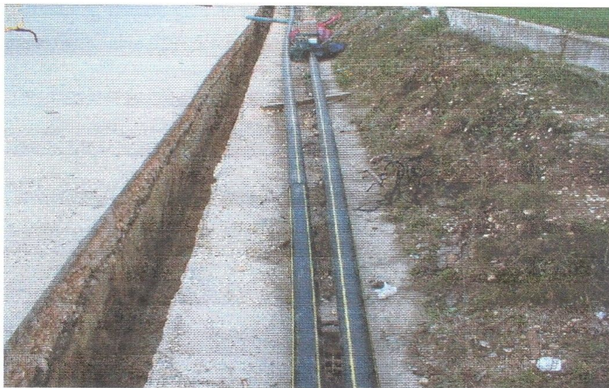
Figura 2 – Tubagem em polietileno
