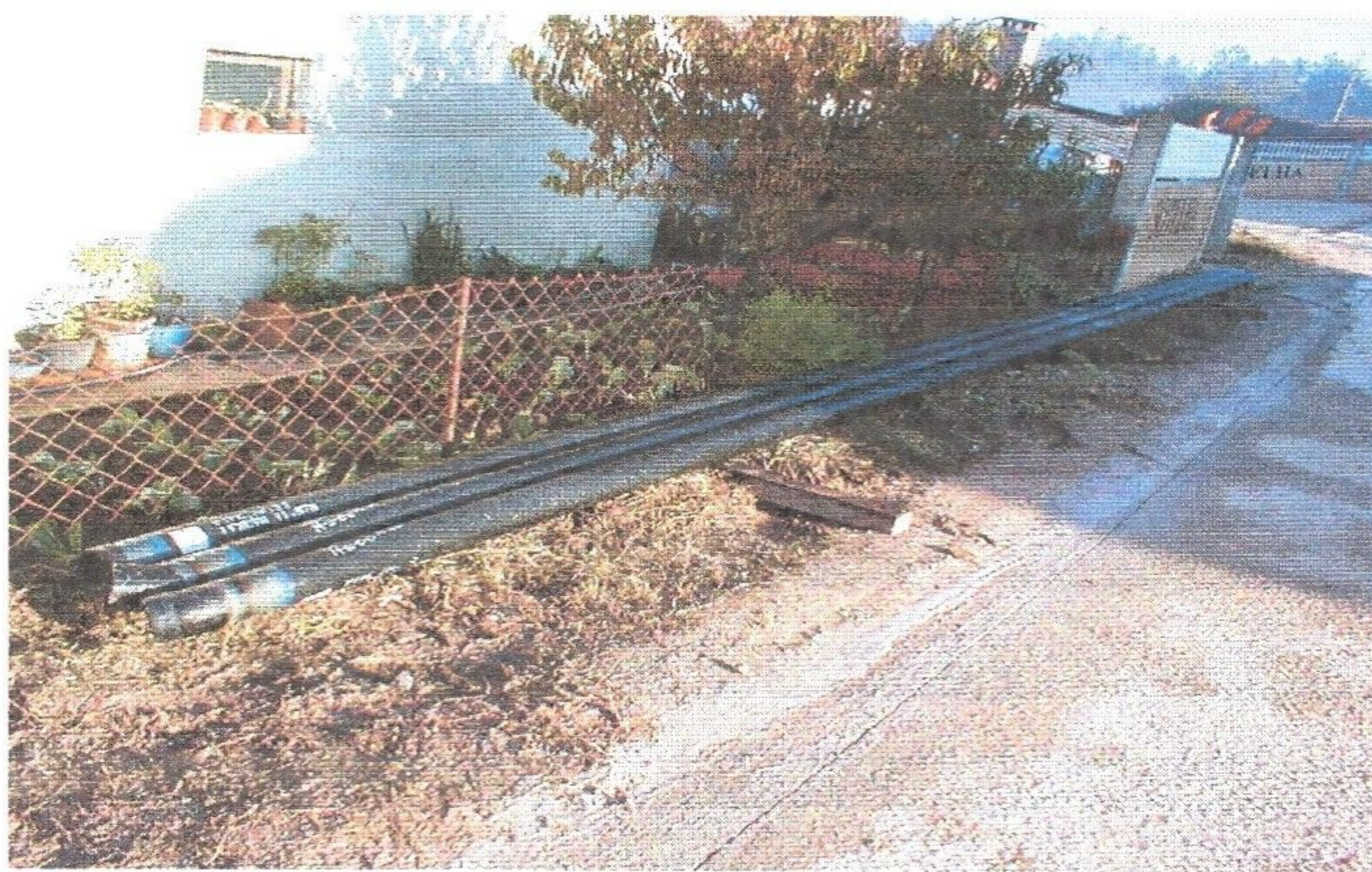
Figura 1 – Tubagem para uma rede primária
