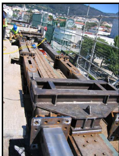
Figura 4.17 – Sistema activo de macacos hidráulicos
