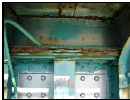
Figura 4.14 – O estado de corrosão do banzo superior (secção de apoio)
