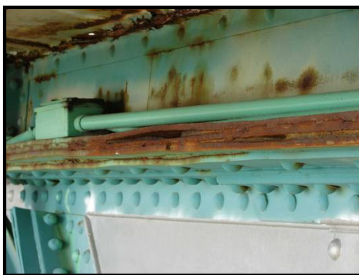
Figura 4.13- O estado de corrosão do banzo superior (secção corrente)
