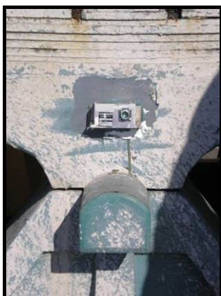
Figura 3.6 – Inclinómetro sem protecção
