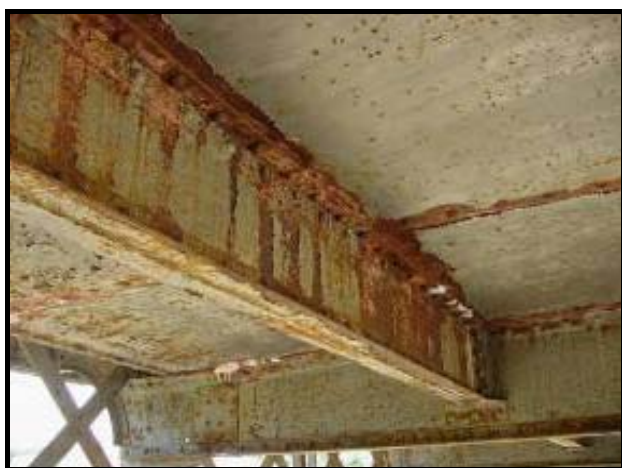
Figura 2.9 – Exemplo de uma pintura em avançado estado de degradação [10]
