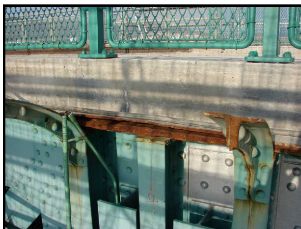
Figura 2.13 – Banzo, em contacto com betão, em avançado estado de corrosão
