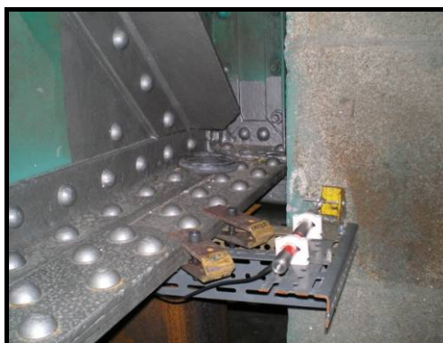
Figura 5.81 – LVDT na Corda Inferior
