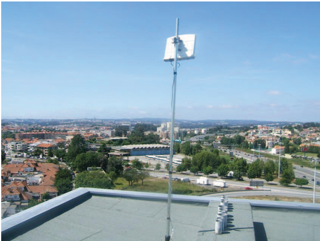
Figura 4.2 - Base Station WiMAX instalada na cobertura do edifício do IDMEC/INEGI
