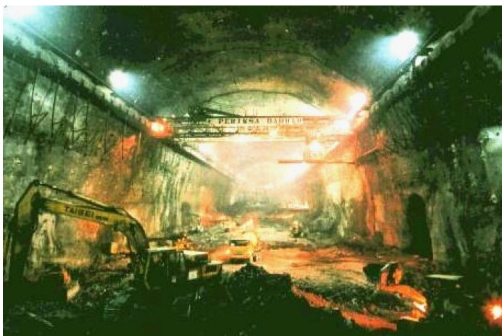
Fig. 2.8 – Caverna da central hidroeléctrica da central de Cirata, na Indonésia [18]
