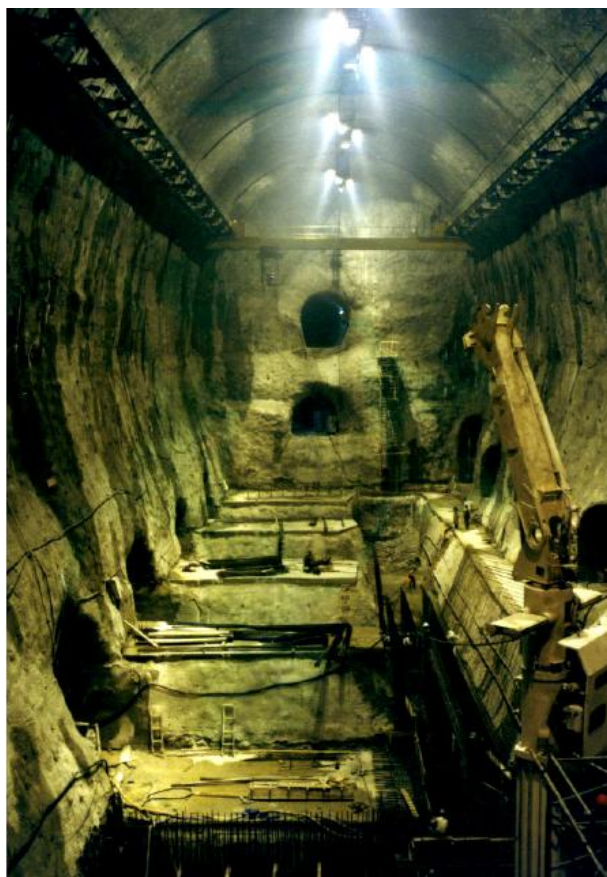
Fig. 2.7 – Caverna da central hidroeléctrica de Singkarak, na Indonésia [18]
