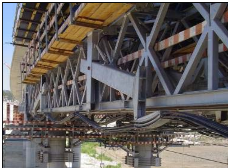
Fig.59 – Sistema de recolha das escoras de desvio [20].
