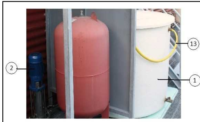
Figura 27 – Foto tirada no piso superior ao laboratório. 1- Reservatório de água; 2- Electrobomba; 13- Mangueira de retorno.
