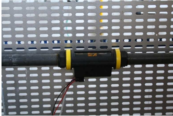
Figura 34 – Foto do transmissor de caudal tipo turbina colocado antes da válvula de teste.
